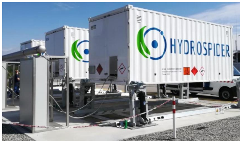
Abbildung 6: Abfüllstation mit Logistikkomponenten für die Wasserstoffproduktion und Auslieferung [89].
