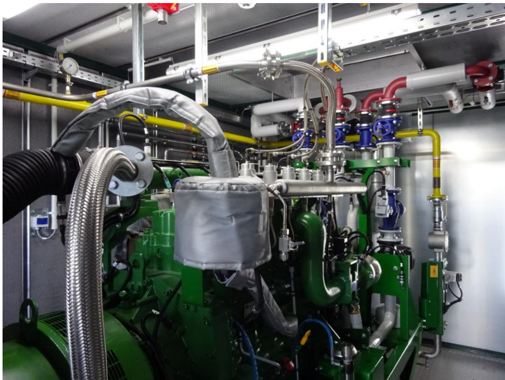
Abbildung 7: Stationärer Wasserstoffverbrennungsmotor (Wasserstoff-BHKW).
