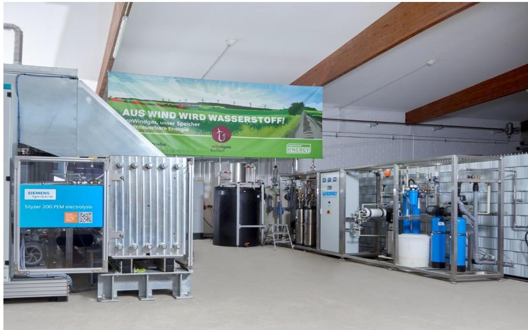
Abbildung 4: 1,25 MW el PEM-Elektrolyseur (links) mit Wasseraufbereitung (rechts) in der Stadt Haßfurt [67].
