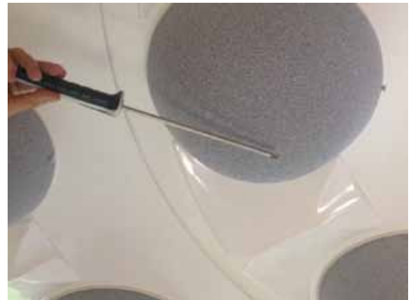
Bild 4: Thermoanemometer unterhalb der Luftauslässe im Opragon
