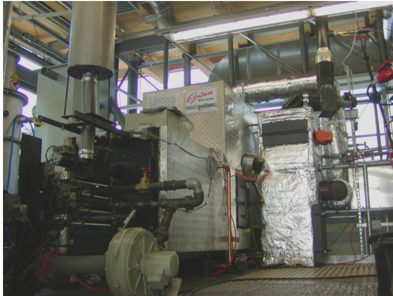
Abbildung 3: Feuerungsprüfstand an der FH Amberg-Weiden
